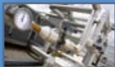
Chaufferies et climatisations
