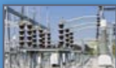
Redes de electricidad
