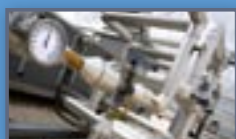
Salas de calderas y climatización
